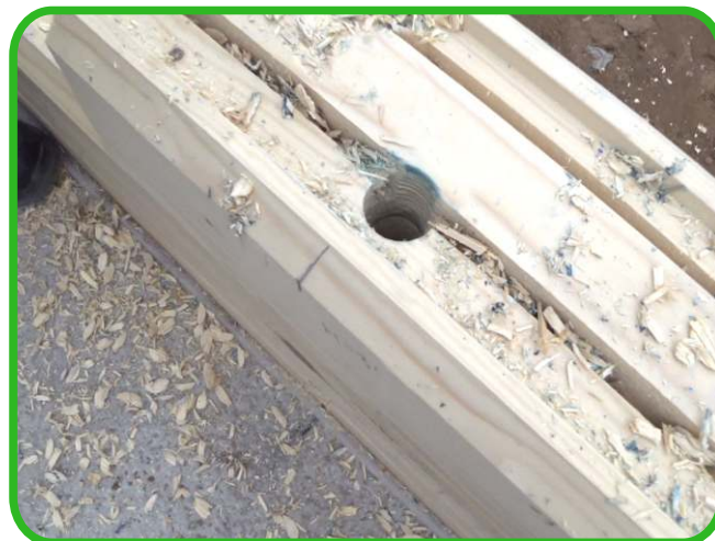
Вертикальный канал для электропроводки
